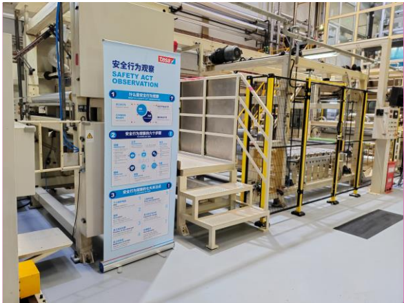
安装安全栅栏后的设备
